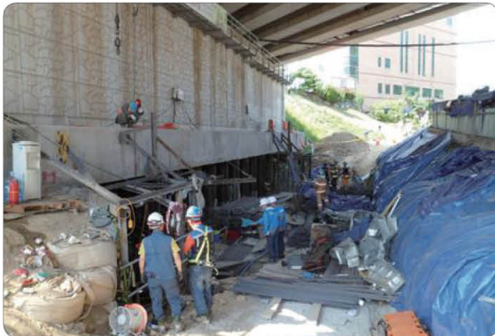
복선 전철 교량 하부 보강 중 LPG 폭발 ('16.6.1. 사망4, 부상 10)
