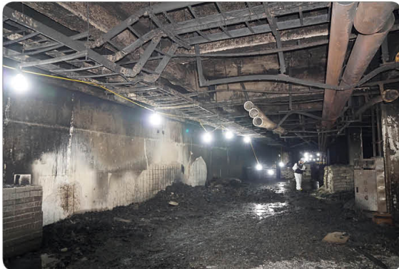
주상복합 신축공사 중 화재 ('18.6.26. 사망 3, 부상 37)
