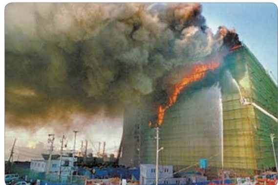
부산 냉동창고 신축공사 화재 ('98.10.29. 사망 27, 부상 16)
