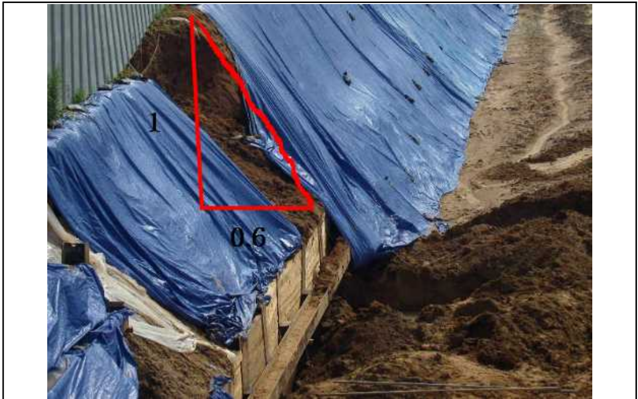
재해 발생 현장 전경
