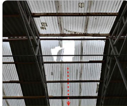
지붕 보수 중 추락(사망 1)
