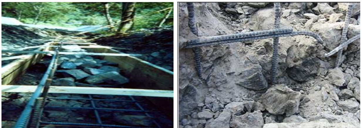
주 : 산림조합이 시공한 충남 부여 산사태 대비 석축공사에서 공사비를 절감하기 위하여 콘크리트 대신 돌덩이로 채워진 부실공사 모습(출처 : 오마이뉴스, 2003. 11. 12)
