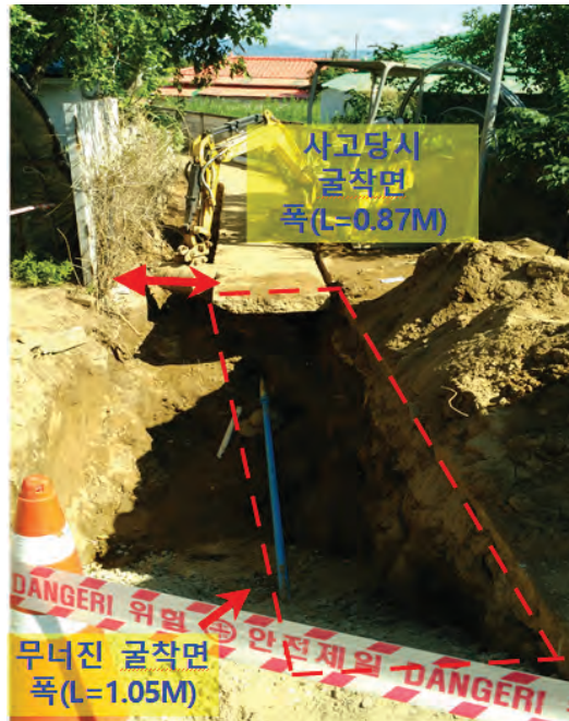
[사진1] 재해발생 현장 전경
