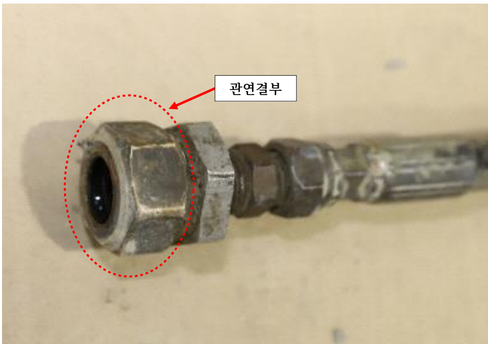
28. 중간밸브 파손형태 / 관연결부
