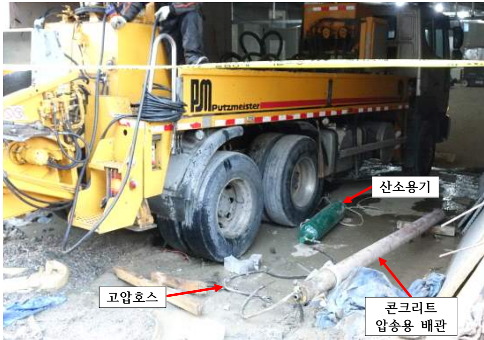
21. 산소용기-고압호스 사용 시점 재연
