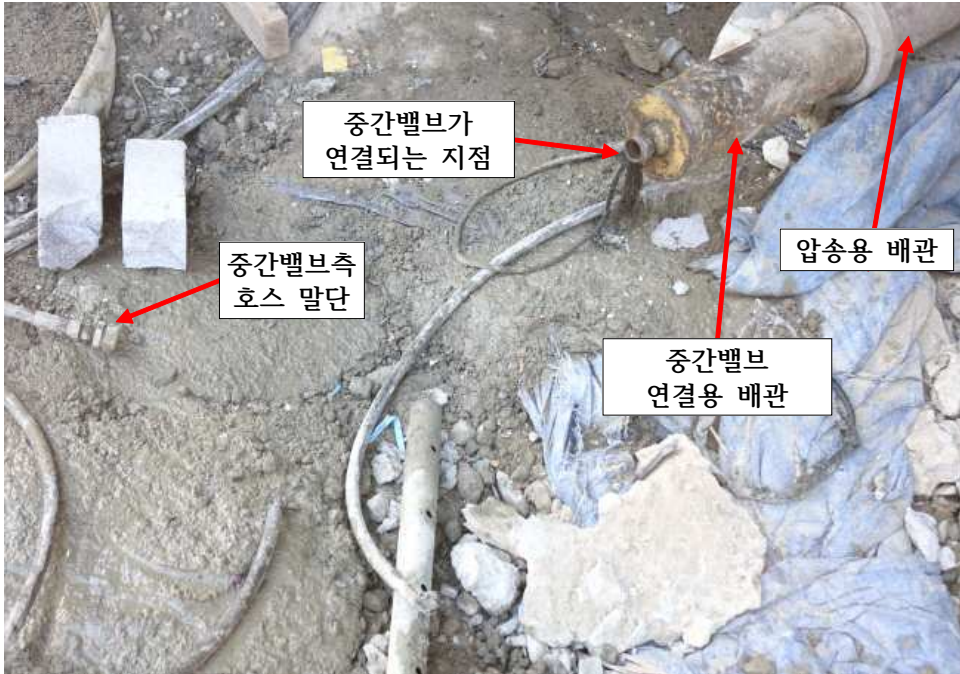
15. 호스-중간밸브-압송용 배관이 연결되는 지점
