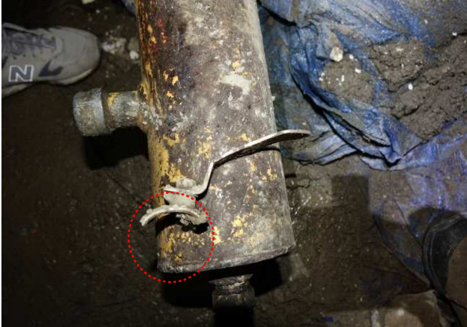
19. 파손된 중간밸브 몸체
